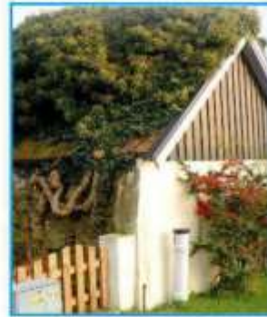
Schade aan dak
