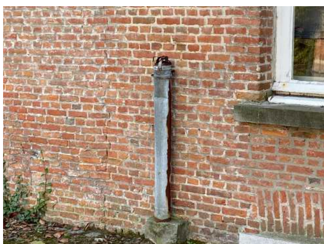
GESCHEURDE BAKSTEEN IN DE GEVEL LANGS DE NETE-ARM
