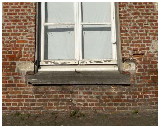
DORPEL VAN GEBOUW A IS GESCHEURD EN LINKS IS EEN STUK AFGEBROKEN
