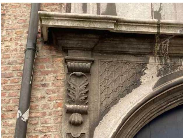
RISALJET MET ROETVERVUILING, DRUIPSPOREN EN KALKAFZETTING
