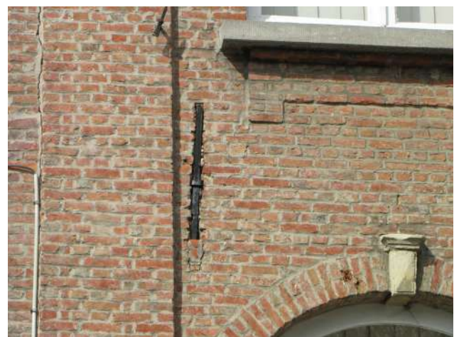
VERROESTE INGEWERKTE ANKERS IN DE TUINGEVEL
