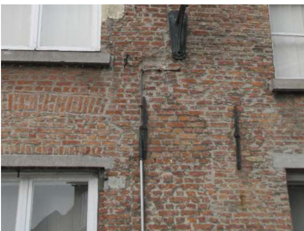
OPLIGGENDE VERROESTE ANKERS IN DE STRAATGEVEL
