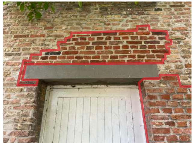
LATERE INVULLINGEN MET BAKSTEEN (AANGEDUID IN HET ROOD) VAN DE NETEGEVEL VAN HET WATERPAVILJOEN (GEBOUW F). DEZE WAS NIET ZICHTBAAR ACHTER HET PLEISTERWERK
