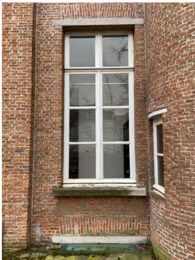
19DE EEUWS RAAM NETEGEVEL GEBOUW H MET AFBLADERING VAN VERF
