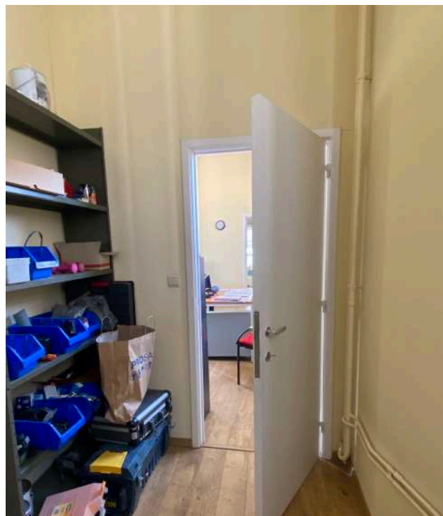
DE ENKELE DEUR MET INVULWAND IN RUIMTE 1.14 IS STOREND
