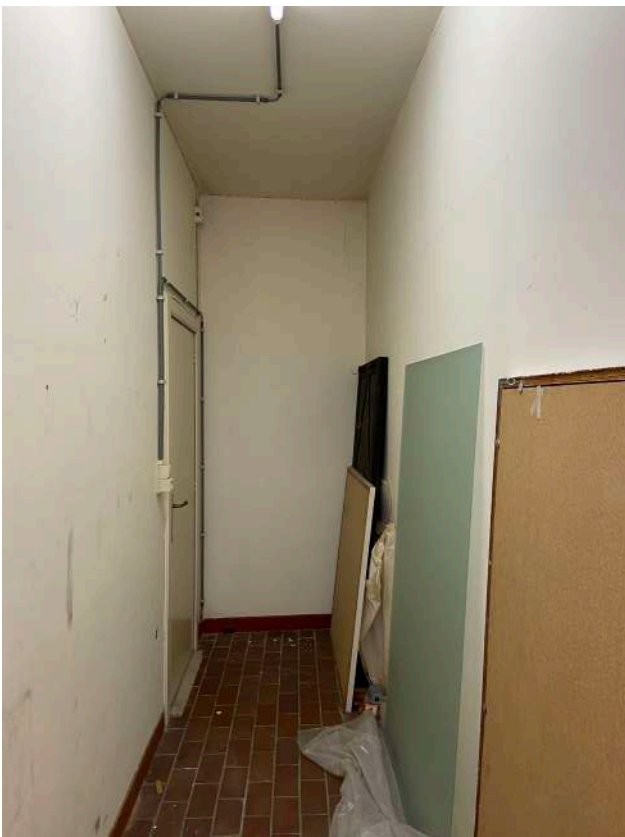
DE TEGELVLOER IN RUIMTE 0.05 IS STOREND
