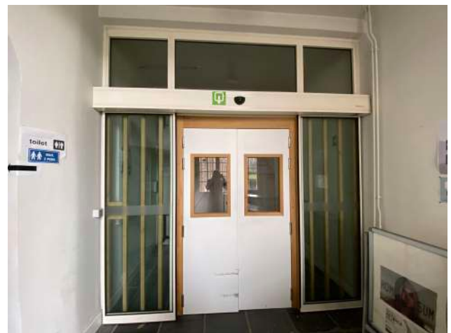
DE SASDEUR IN RUIMTE 0.01 IS STOREND
