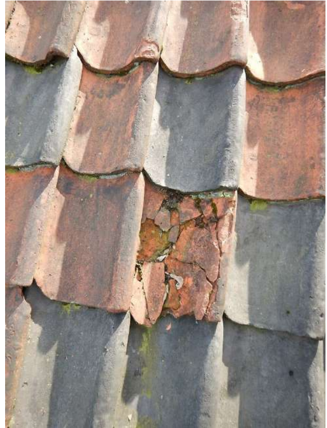
STERK VERWEERDE DAKPAN (BRON: MONUMENTENWACHT)
