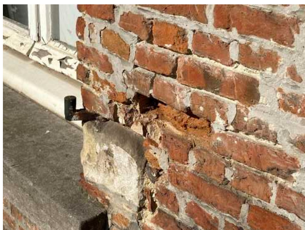
VERWEERDE BAKSTEEN GEBOUW A DOOR VORST
