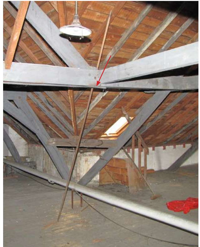
ONTBREKEND SPANTBEEN DAK 7 (GEBOUW H)
