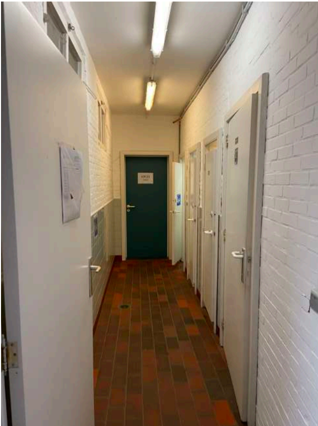
DE TEGELVLOER EN 20STE EEUWSE INVULLINGEN MET SCHRIJNWERK ZIJN STOREND.
