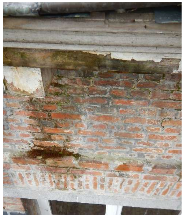
INGESCHEURD UITZETSTUK, VERVOLGSCHADE OP ONDERLIGGEND MUURWERK (BRON: MONUMENTENWACHT)
