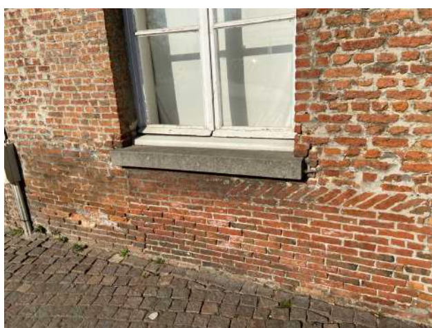
UITGESPOELD VOEGWERK GEBOUW A
