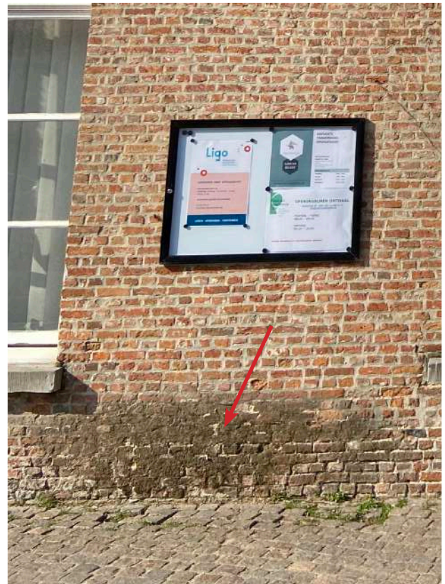
STERKE VERVUILING VAN DE GEVEL VAN GEBOUW B ONDERAAN
