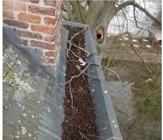
VERVUILDE GOOT (BRON: MONUMENTENWACHT)
