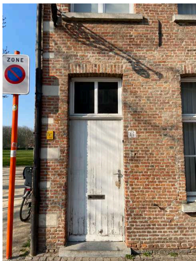
20STE EEUWSE VOORDEUR VAN GEBOUW G MET HOUTROT EN AFBLADERENDE VERF
