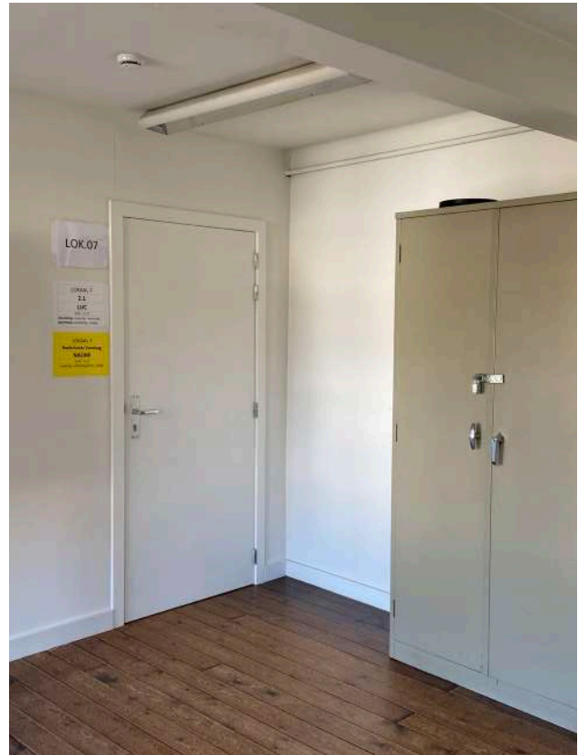
DE ENKELE DEUR MET INVULWAND IN RUIMTE 1.05 IS STOREND
