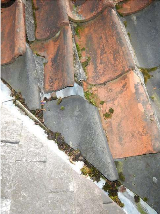
UITGEZAKTE DAKPANNEN (BRON: MONUMENTENWACHT)
