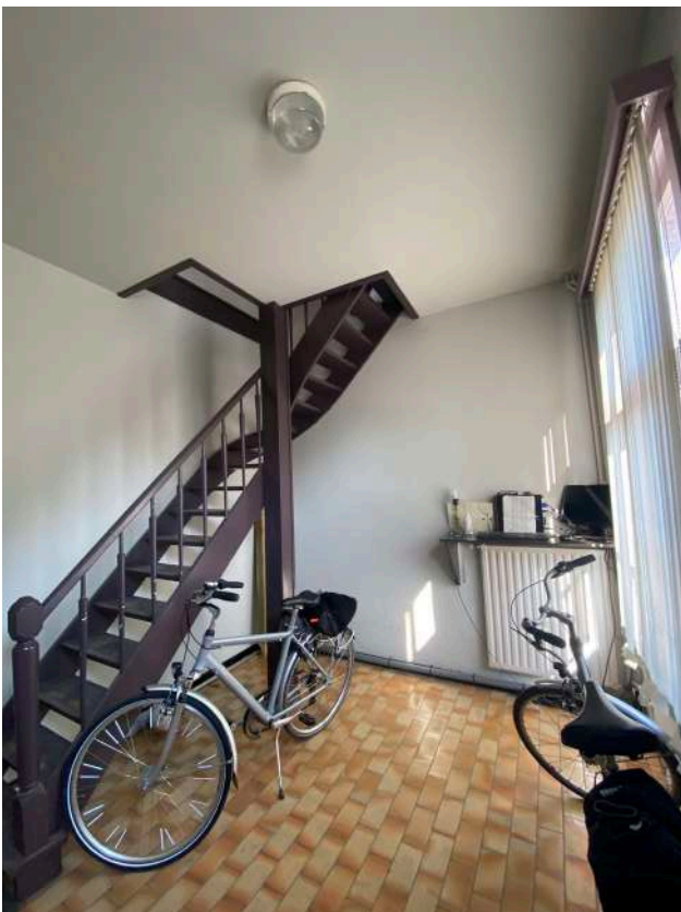
DE TEGELVLOEREN ZIJN STOREND EN DE TRAP IS INDIFFERENT.
