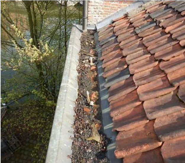
VERVUILDE GOOT (BRON: MONUMENTENWACHT)
