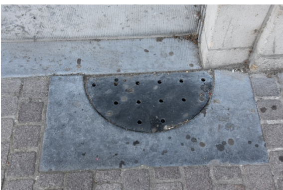
Afbeelding 67: Keldergatopening afgedekt met metalen beplating
