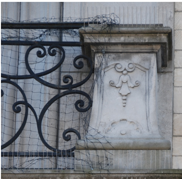
Afbeelding 65: Slordig aangebrachte duivenwering (netten)
