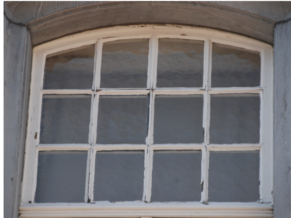
Afbeelding 54: Verdwenen stopverf en afbladderende verf
