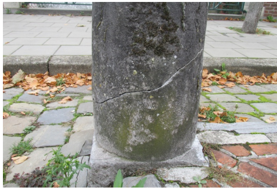
Afbeelding 89: Scheur hardstenen baluster vismijn
