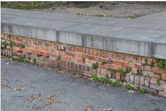
Afbeelding 80: Uitgevallen voegwerk en plantengroei
