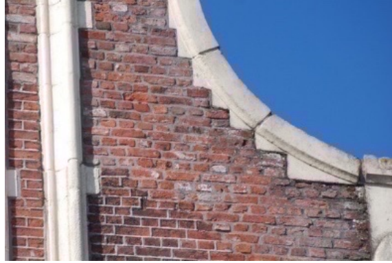
Afbeelding 46: Vorstschade t.g.v. waterinfiltratie
