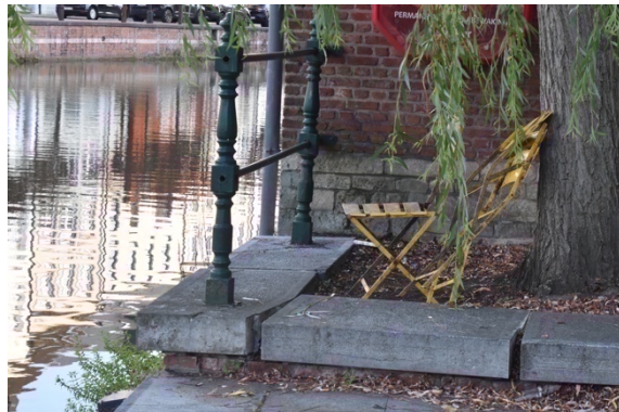
Afbeelding 81: Losgeduwd en gebarsten dekstenen
