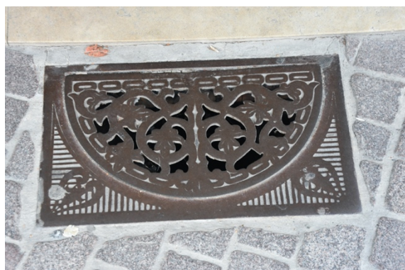
Afbeelding 68: Keldergatopening afgedekt met decoratief metalen rooster
