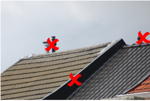
Afbeelding 116: Storende schoorsteenelementen en zijgevelafwerking
