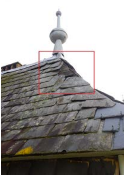
Afbeelding 331. Beschadigde en weggeschoven leien. (Bron: verslag Monumentenwacht (12699/2019/B), p. 13)
