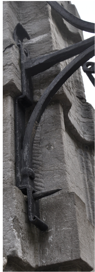
Afb. 15. ontbrekende bevestigingspunten van het opvangsysteem van de zwengel
