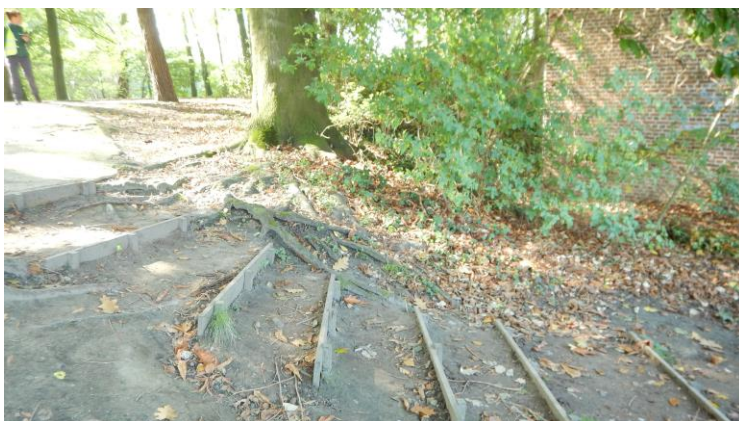
Fig. 6.29: Blootliggende boomwortels (BG032 Beuk) door verkeerde trapinrichting (foto: 25/09/2017)
