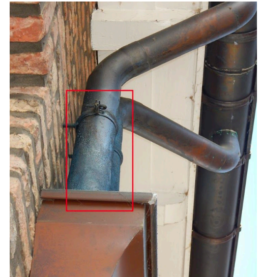
Afbeelding 226. Aangevreten koper. (bron: verslag Monumentenwacht, 2019, p. 13)
