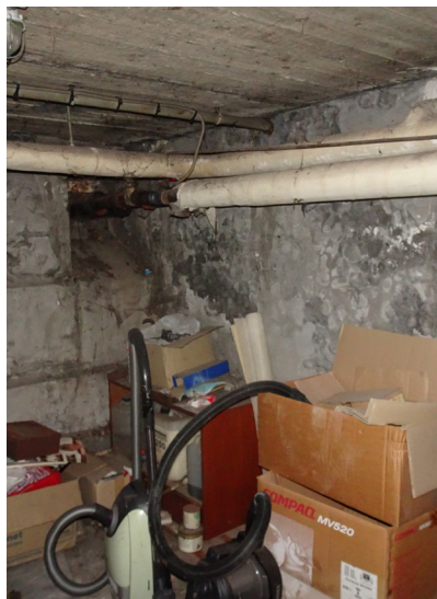
Afbeelding 252. Zout- en vochtschade in de kelder.
