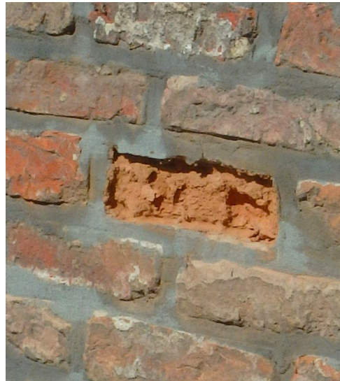
Afbeelding 232. Kapotgestraalde baksteen. (bron: verslag Monumentenwacht, 2019, p. 14)
