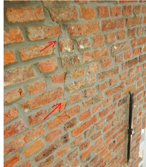
Afbeelding 229. Lichte zettingsscheuren. (bron: verslag Monumentenwacht, 2019, p. 15)
