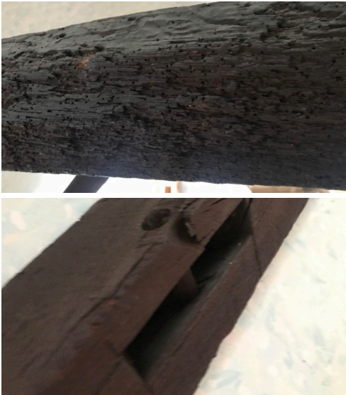
Afbeelding 219. Aangetaste dakstructuur en 'leeg' verbindingsgat.
