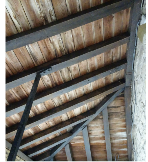
Afbeelding 182. De dakstructuur van het dak boven de toegangsdeur is in goede staat.
