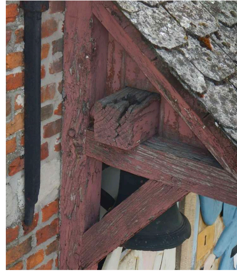
Afbeelding 181. Verweerde houten structuur van de afdakjes in zuidwestgevel. (bron: verslag Monumentenwacht, 2018, p. 18)
