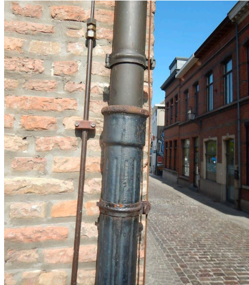
Afbeelding 228. Verroeste standpijp. (bron: verslag Monumentenwacht, 2019, p. 14)
