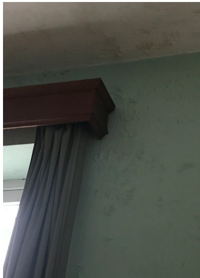
Afbeelding 249. Zout- en vochtschade op de verdieping.
