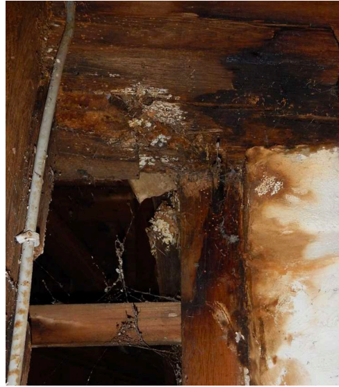
Afbeelding 180. Aangetaste dakstructuur t.h.v. de natuurstenen schoorsteen. (bron: verslag Monumentenwacht, 2018, p. 11)
