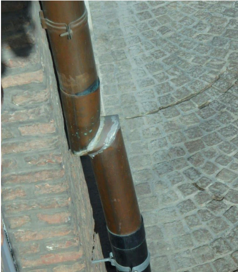
Afbeelding 227. Hoekig uitgewerkte afvoer. (bron: verslag Monumentenwacht, 2019, p. 12)
