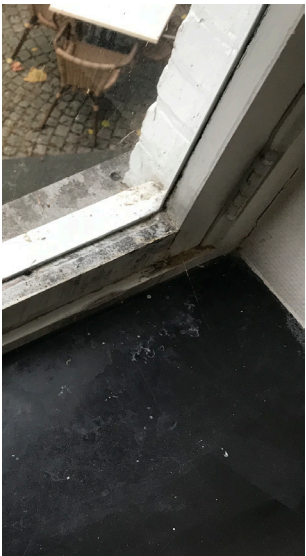
Afbeelding 247. Schade aan raam ten gevolge van vocht.
