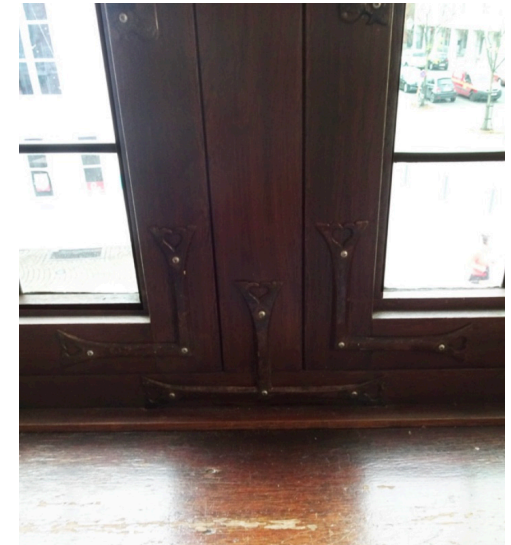
Afbeelding 214. Het hang- en sluitwerk is over het algemeen in goede staat.
