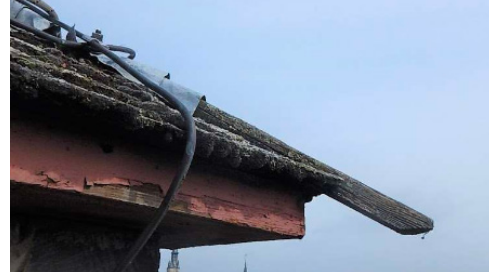
Afbeelding 189. Hanggoot (noordwestgevel) en verschaalde boardplank. (bron: verslag Monumentenwacht, 2018, p. 9 en 10)
