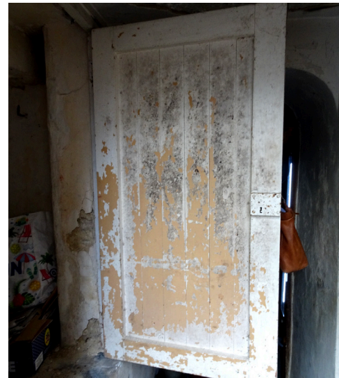
Afbeelding 213. Verweerde verflaag bij deur in gangetje naar kelder.
