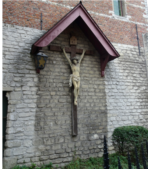
Afbeelding 196. Verkleuring van natuursteen in de noordoostgevel.
