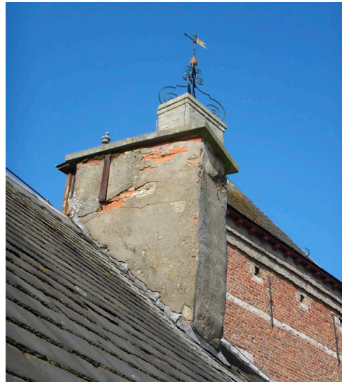
Afbeelding 224. Verweerde cementpleister. (bron: verslag Monumentenwacht, 2019, p. 11)
