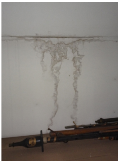
Afbeelding 251. Vochtschade op de zolder.
