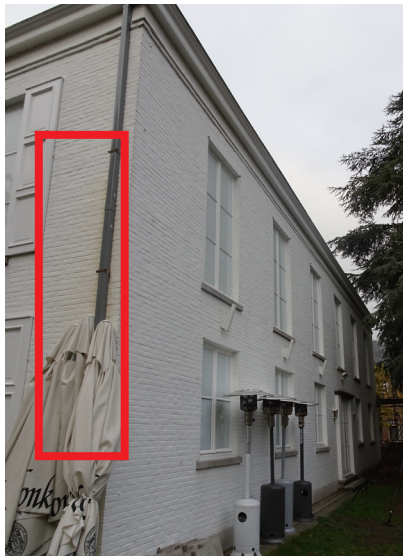
Afbeelding 248. Plaatselijk is de gevelafwerking vervuild of verkleurd.
