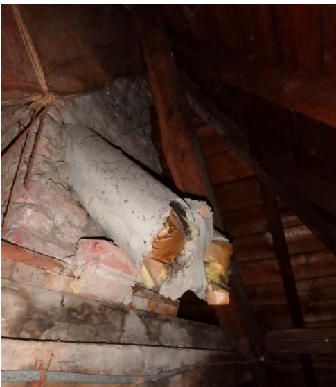
Afbeelding 243. Asbest op de zolder. (bron: verslag Monumentenwacht, 2019, p. 6)
