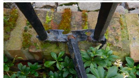
Afbeelding 201. Roestige lantaarn en hekwerk (bron: verslag Monumentenwacht, 2018, p. 13)
