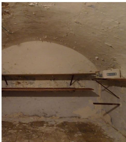
Afbeelding 246. De kelder wordt niet goed verlucht waardoor deze vochtig is.
