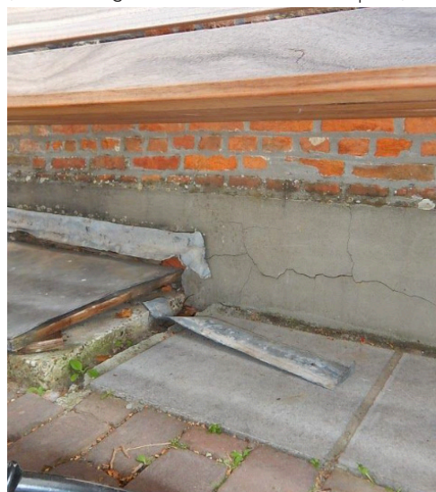
Afbeelding 238. Loskomende cementplint aan zuidwestzijde. (bron: verslag Monumentenwacht, 2019, p. 16)
