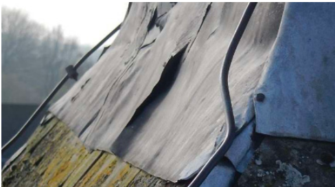
Afbeelding 187. Verweerde loodaansluitingen. (bron: verslag Monumentenwacht, 2018, p. 8)
