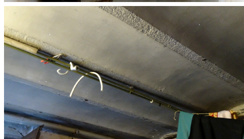
Afbeelding 218. Verweerde bepleistering en aangetaste troggewelven (roestige profielen en afbladderende verf).
