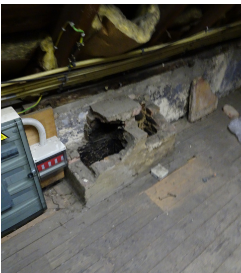
Afbeelding 245. Het schouwkanaal aan de zuidwestzijde is niet meer verbonden met de schoorsteen.
