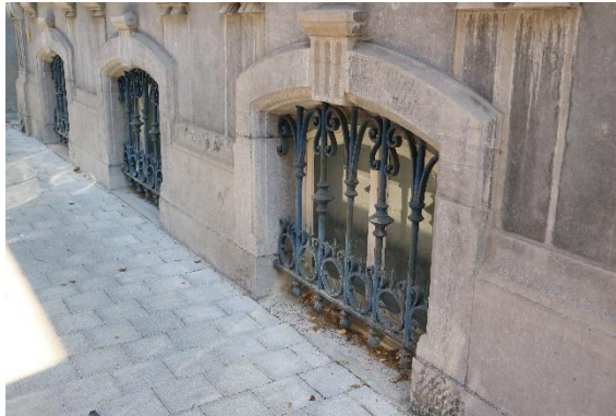
Gietijzeren kelderrooster Sint-Gummarusstraat 22
