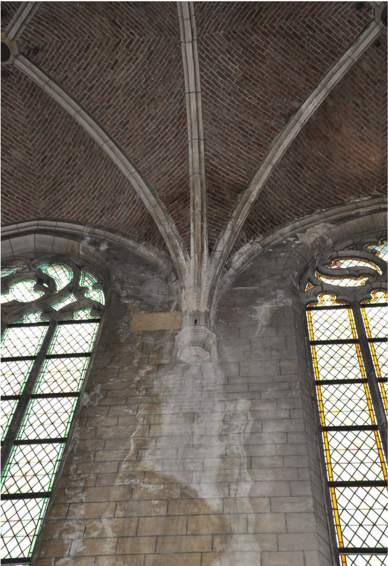
Afb. 54. Glas-in-loodramen en vochtschade aan de gewelven en muur van de noordelijke zijbeuk.
