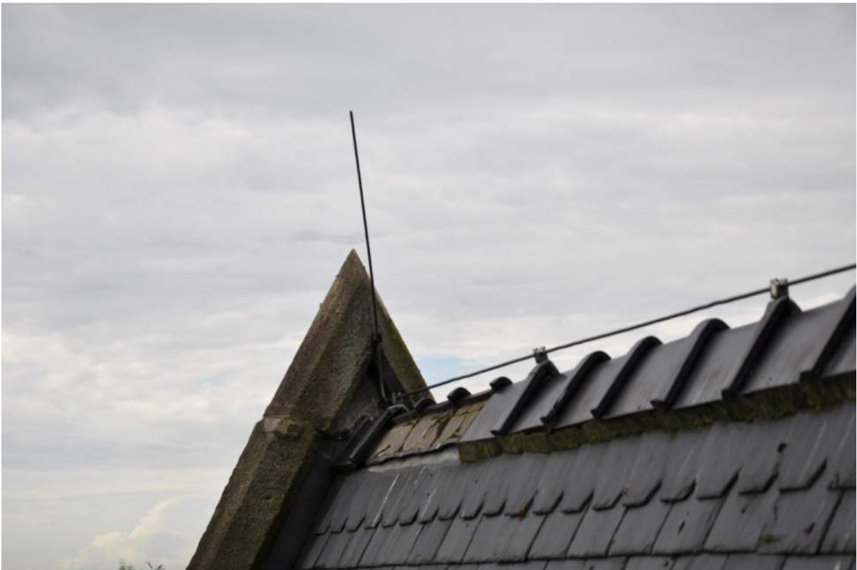
Afb. 30. Ontbrekende nokpannen op een van de daken van de zijbeuk.
