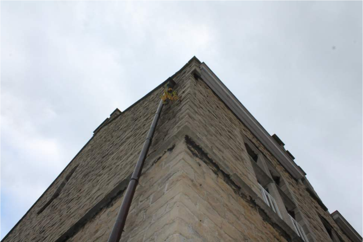
Afb. 90. De regenwaterafvoer tegen de zijgevel.
