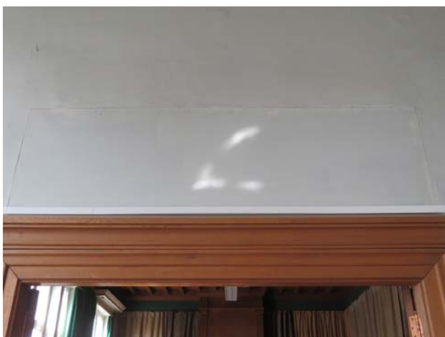
FOTO WAAR DE AFTEKENING BOVEN DE HUIDIGE DEUR VERWIJST NAAR DE INITIËLE DEURHOOGTE VAN DE 19DE EEUWSE DEUR VAN VAN OCKELEYEN _BRON: KARUURARCHITECTEN
