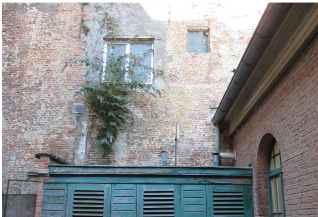
OP DE MIDDELEEUWSE SCHEIMUUR MET BUUR NR.6 ZIEN WE NOG DE AFTEKENING VAN DE LINKERZIJGEVEL ZOALS OPGETEKEND OP HET KADASTERPLAN VAN 1826_BRON: KARUURARCHITECTEN
