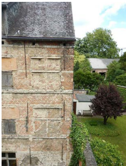
ZUIDGEVEL LIJKT LOS TE SCHEUREN _ BRON: MONUMENTENWACHT INSPECTIERAPPORT 2019
