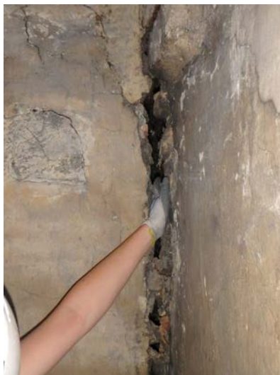
SCHOUWKANAAL KOMT LOS VAN HET ACHTER- LIGGENDE MUURWERK _ BRON: MONUMENTEN- WACHT INSPECTIERAPPORT 2019
