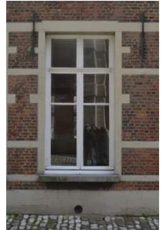
Fig.04. Detail straatgevel: raam rechts begane grond
