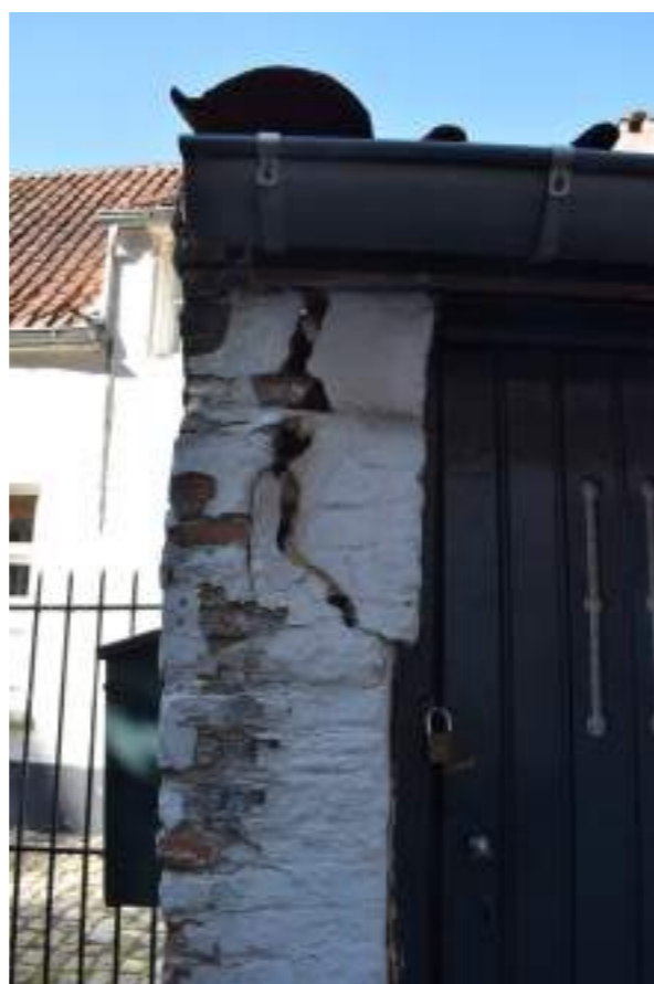
Fig.04. Detail verweerd metselwerk aanbouw
