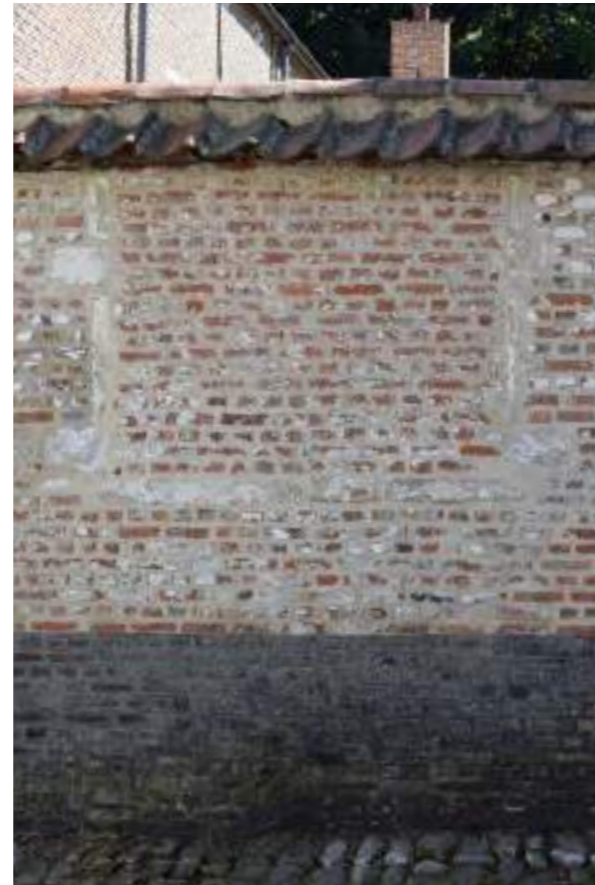
Fig.11. Detail ommuring met omlijsting verdwenen raamopening
